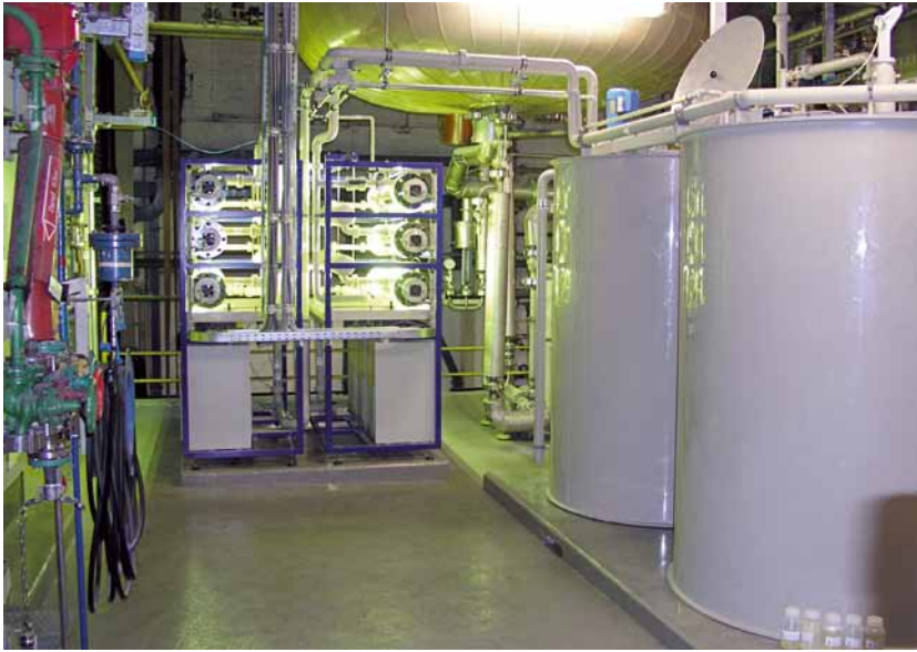
Die UV-Oxidationsanlage wandelt Antibiotika und Röntgenkontrastmittel in unschädliche Verbindungen um.
