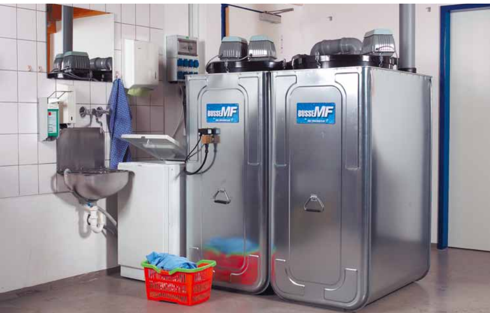
Die Hauskläranlage befindet sich in solchen geruchsdichten Behältern und kann im Keller untergebracht werden.
