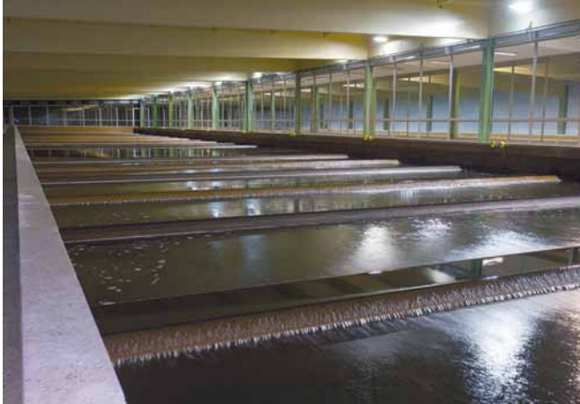
In der Schnellfilteranlage durchfließt das Wasser eine Sandschicht, die Eisen- und Manganoxide zurückhält.
