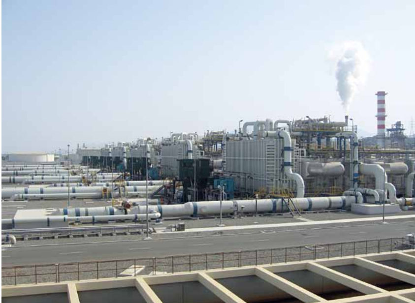
In dieser thermischen Anlage in den Vereinigten Arabischen Emiraten entsalzt man das Meerwasser durch Verdampfen.
